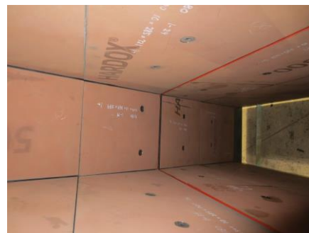
耐摩耗鋼HARDOX500 破砕機下部シュート
