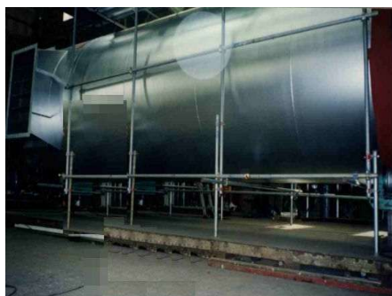
排ガス処理施設急冷タンク
