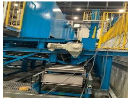
鑄造設備搬送コンベア
